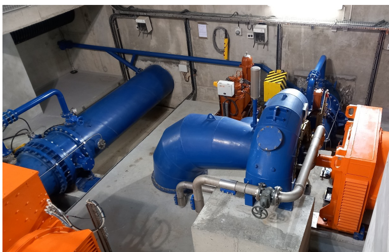
Centrale de Fontenil, photo V. Barnier, 2023
